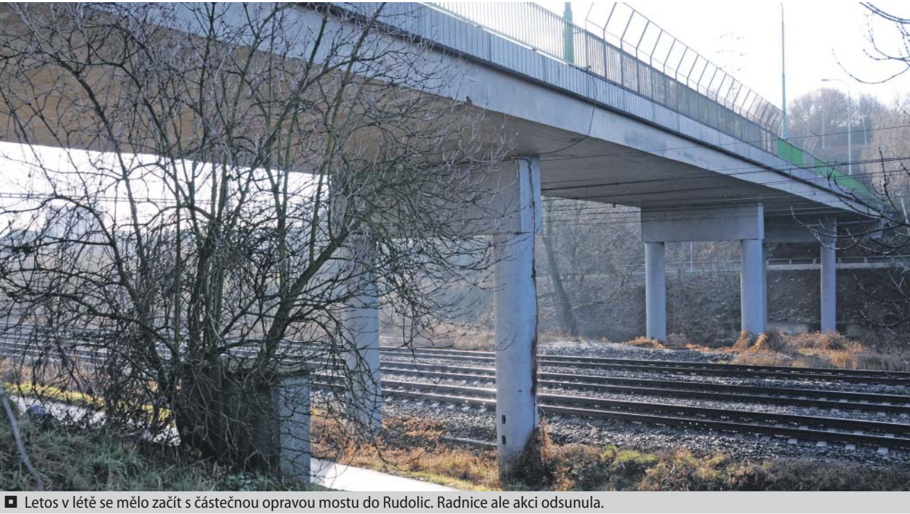
Letos v létě se mělo začít s částečnou opravou mostu do Rudolic. Radnice ale akci odsunula.
