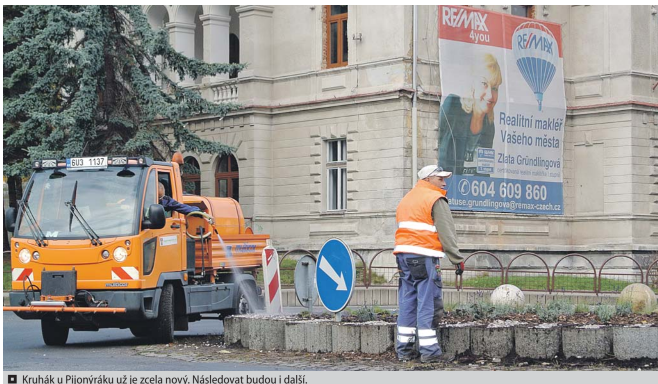
■ Kruhák u Pijonýráku už je zcela nový. Následovat budou i další.
