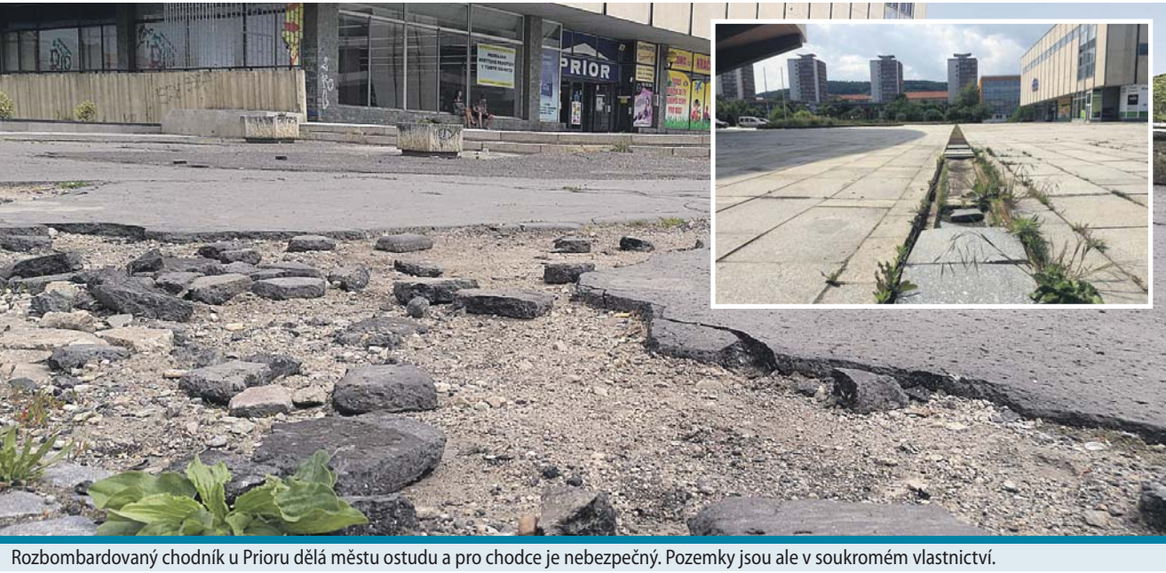
Robombardovaný chodník u Prioru dělá městu ostudu a pro chodce je nebezpečný. Pozemky jsou ale v soukromém vlastnictví.
