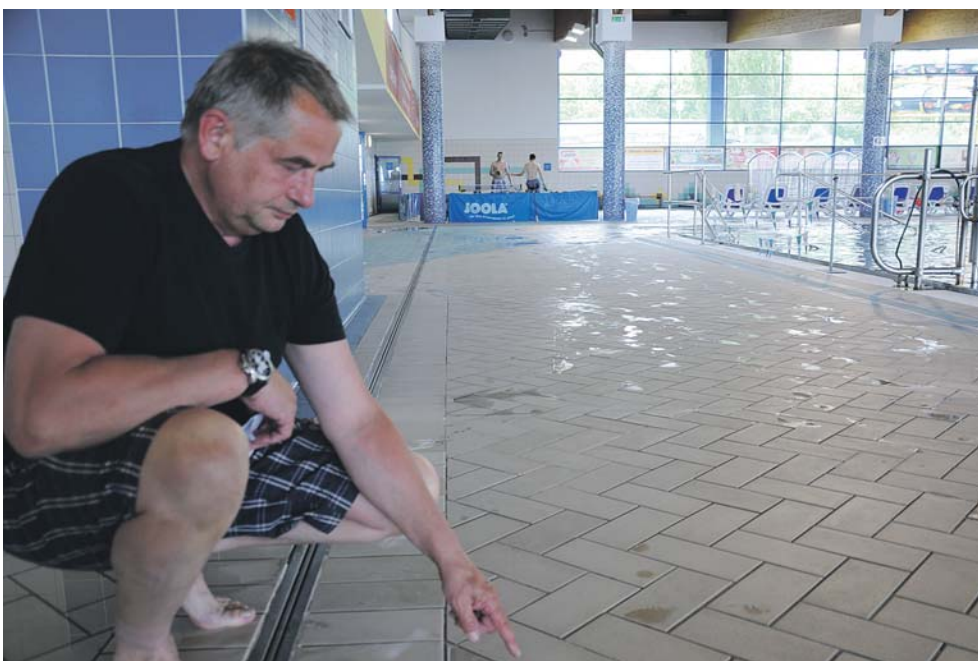
Vedoucí provozu Aquadromu Miroslav Svoboda ukazuje poškozenou dlažbu, která je na mnoha místech haly.
