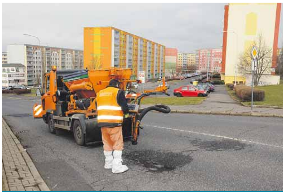
S opravou výtluků se v lednu začalo například i v ulici Okružní. Ta by se měla letos dočkat celkové rekonstrukce.
