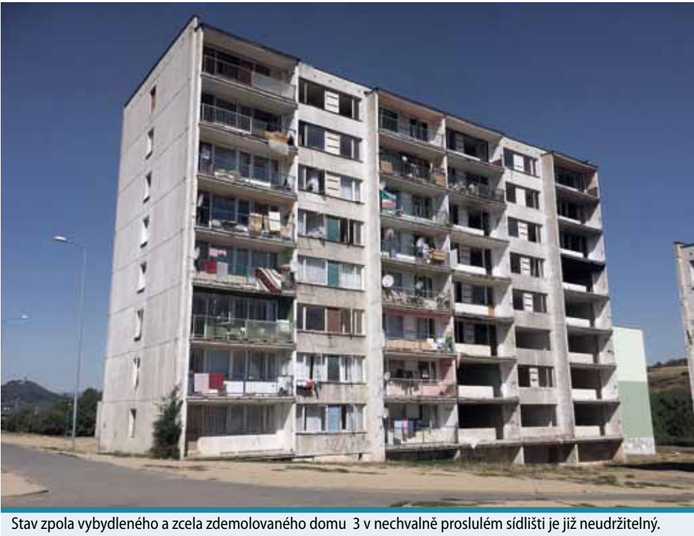
Stav zpolá vybydleného a zcela zdemolovaného domu 3 v nechvalně proslulém sídlišti je již neudržitelný.
