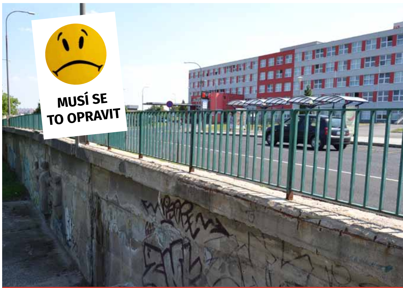
Rekonstrukce mostu u nemocnice už je nevyhnutelná.
