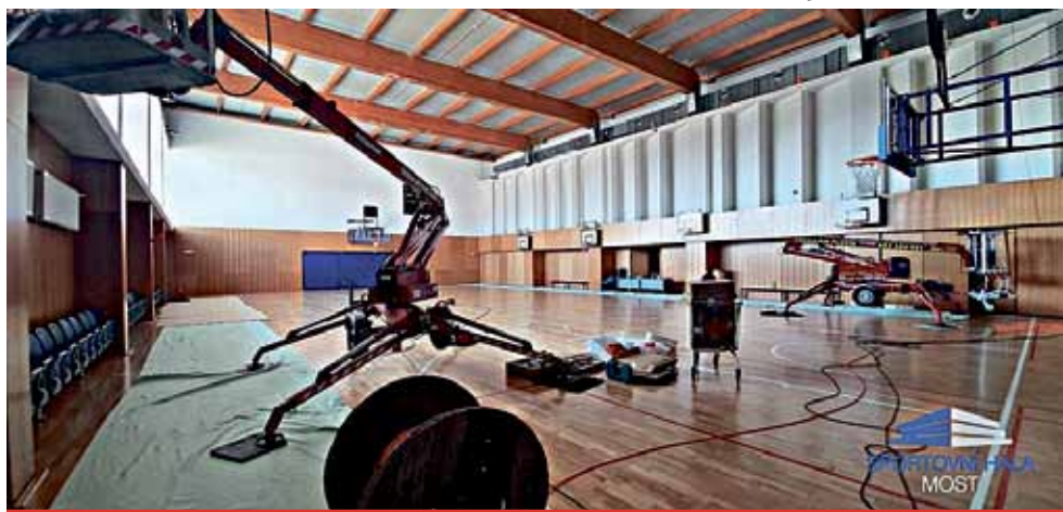
Výměna světel proběhla také na malé hale. Třešničkou na dortu nové světelné technologie jsou čtyři barevné světelné hlavice, které jsou multifunkční a umožňují barevné, světelné efekty.
