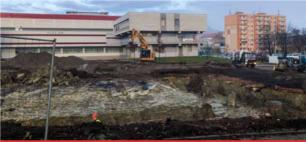
Zodpovědná firma nabírá na stavbě nové haly zpoždění.
